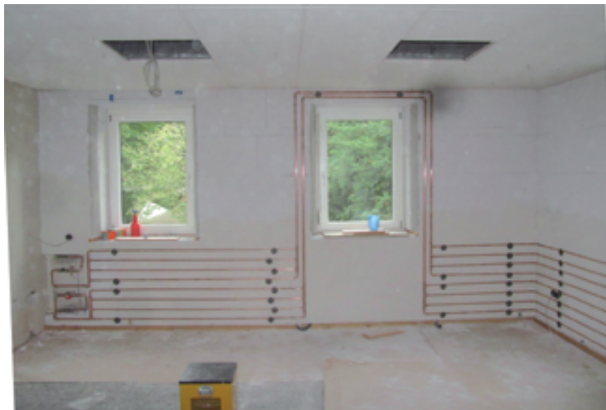
Auf der mineralischen Innendämmung wurden Wandheizungsmodule aus Kupfer direkt mit Schlagdübeln befestigt. Die zukünftige Fluchttür ist ausgespart
