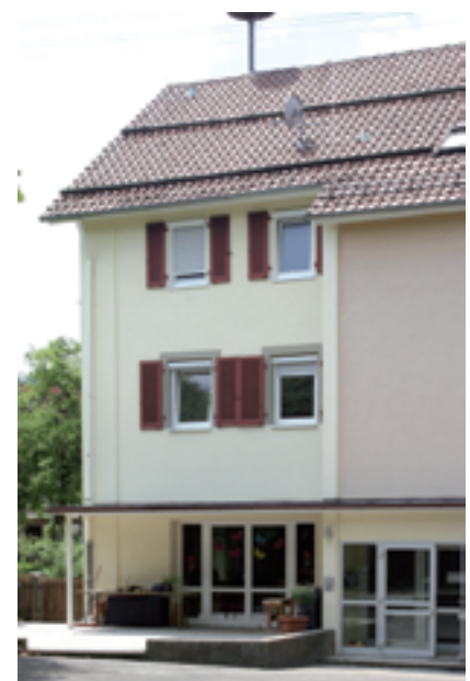
In den 70er Jahren wurde ein Treppenhaus angebaut (rechts im Bild). Vor allem dessen Stirnseiten aus Beton sind Wärmebrücken
