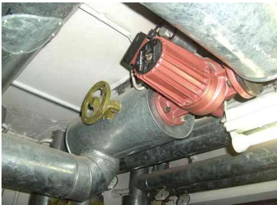
Die eigentlich nicht erforderliche Ladepumpe nahm konstante 140 Watt auf. Eine hydraulische Weiche war nicht vorhanden.
